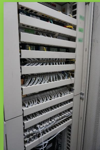
機房光纖及結構化佈線系統
